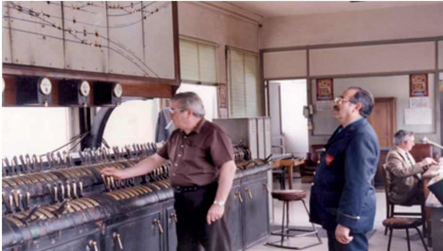
Mesa de Enclavamiento mecánico de los años 80's, https://audioguia.museudelferrocarril.org/cas/02/Mesa-enclavamientos.asp
